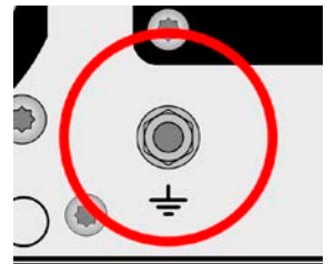
Figure 11 - Point de mise à la terre
